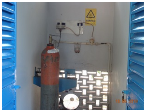
Foto 2 - Sala do cloro sem exaustor.
