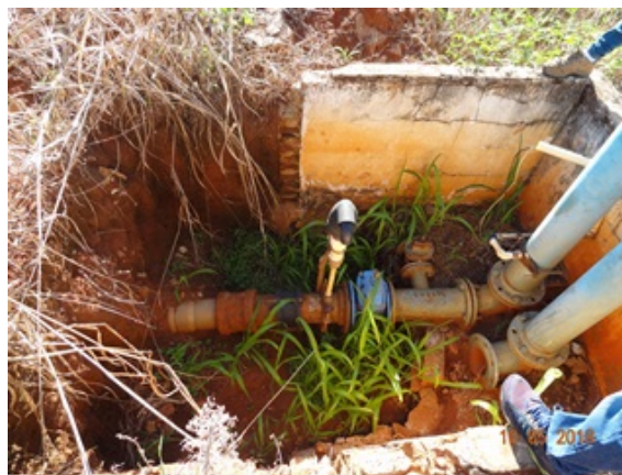
Foto 4 - REL da cidade com caixa de passagem danificada.
