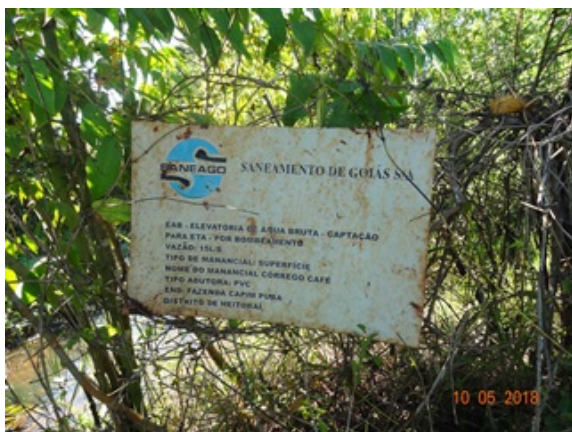
Foto 1 - Captação/EEAB com cerca de proteção danificada.
