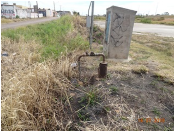
Foto 7 - Poço P 16 interligado a ETA (sem urbanização).
