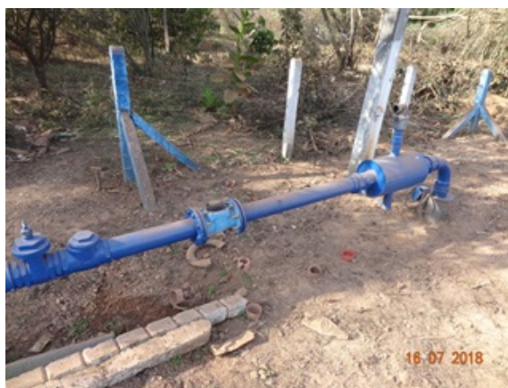
Foto 18 - Poço P 28 interligado à caixa de reunião.
