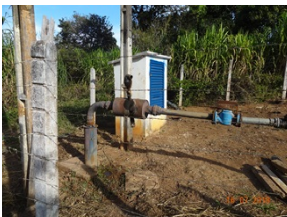
Foto 17 - Poço P 22 interligado à caixa de reunião.
