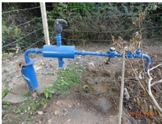
Foto 16 - Poço P 12 interligado à caixa de reunião.
