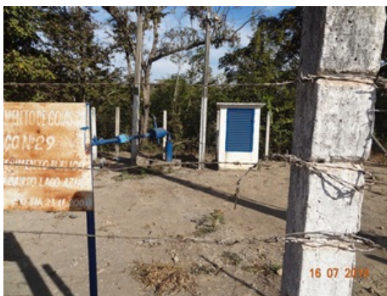
Foto 19 - Poço P 29 interligado à caixa de reunião.
