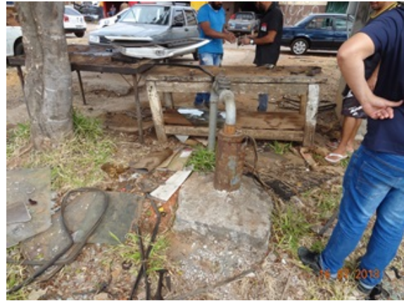
Foto 6 - Poço P 15 interligado a ETA (sem urbanização).
