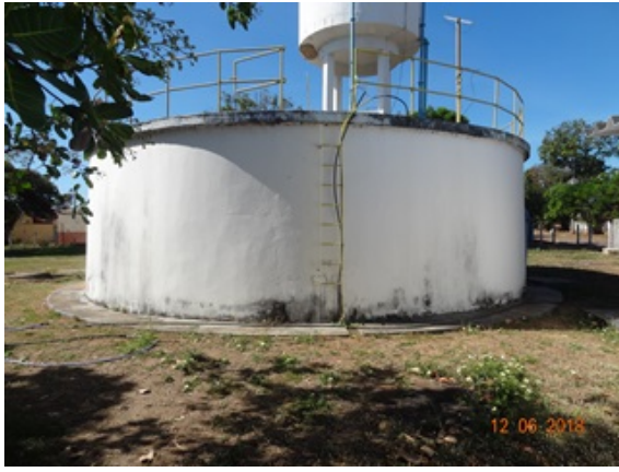
Foto 3 -RAP/Distrito com pintura desgastada.
