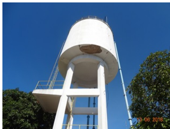
Foto 2 - REL/Distrito com perda de revestimento e pintura desgastada.
