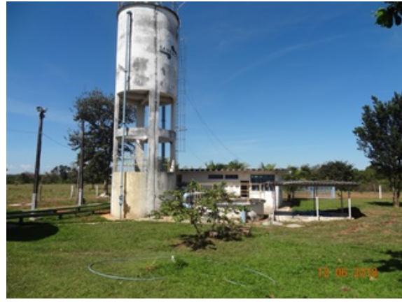
Foto 4 - REL/ETA com pintura desgastada.
