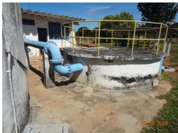
Foto 1 - Pintura desgastada das edificações da ETA.
