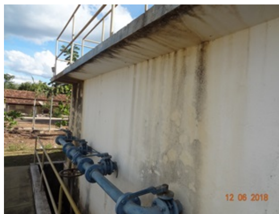
Foto 2 - Pintura desgastada ETA.
