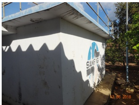
Foto 1 - Pintura desgastada do ETA.
