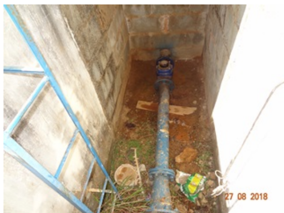
Foto 7 - Macromedidor na saída de REL.
