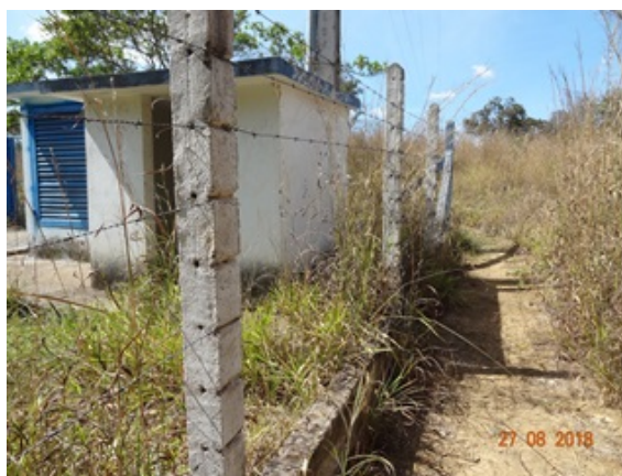
Foto 8 - Cerca danificada na área do poço P02.
