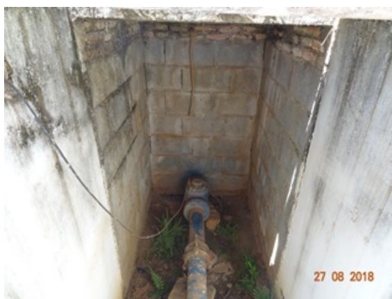
Foto 6 - Macromedidor na saída do RAP.
