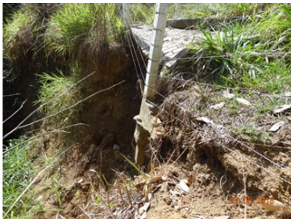
Foto 9 - Erosão com destruição do piso e da boca do poço P02.
