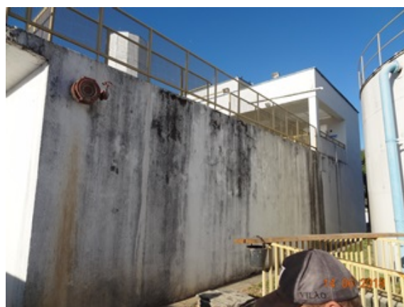
Foto 2 - Pintura desgastada: Filtração, Floco-decantadores e Flocluladores.
