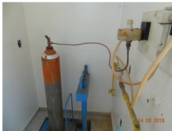
Foto 6 - ETA/Pedro Ludovico Desinfecção - sem placa de aviso de área de risco na sala do clorador.
