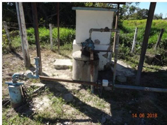
Foto 3 - Poço nº 04 (papius) com abrigo do quadro
