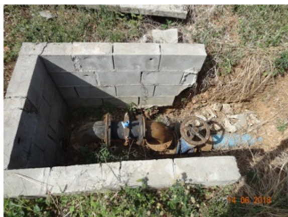
Foto 7 - ETA/Pedro Ludovico com caixas de inspeção ou passagem sem tampa.
