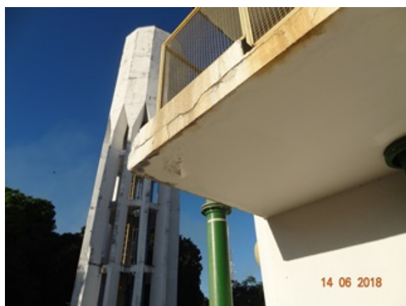
Foto 1 - Pintura desgastada das edificações da ETA.
