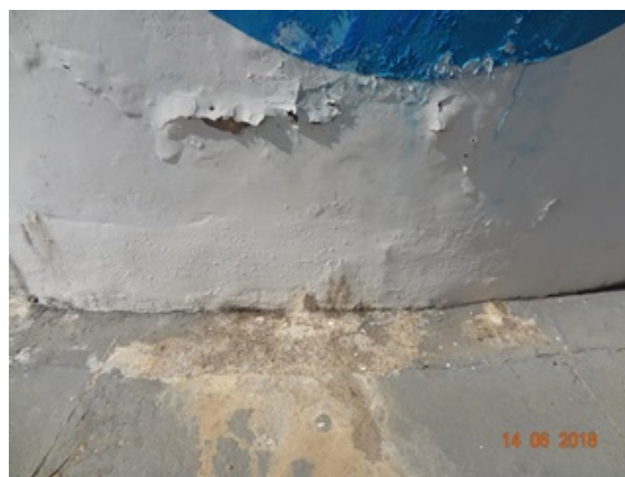
Foto 8 - ETA/Pedro Ludovico/RAP concreto (500 m 3 ) com infiltrações, perda de revestimento e pintura danificada.
