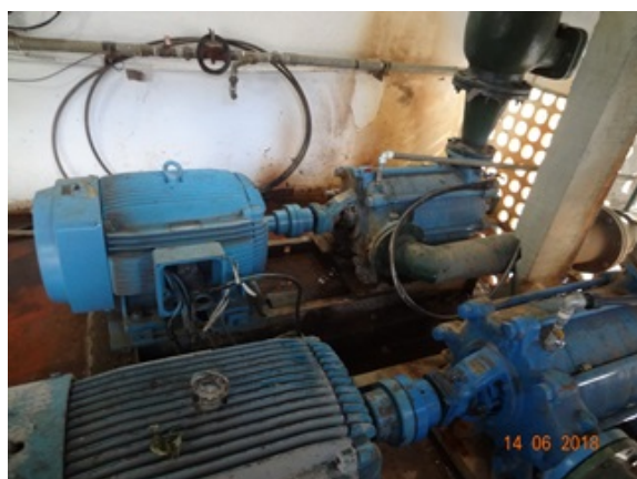
Foto 9 - Captação/EEAB/Córrego Pedro Ludovico com vazamento na bomba.
