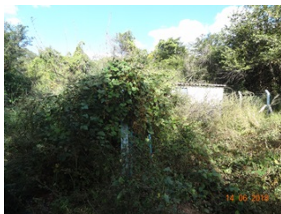
Foto 10 - Poço PGD/256 (carrero) falta portão/e ou cerca de proteção do poço. Área com mato alto.
