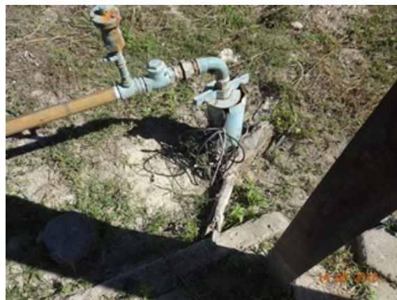
Foto 4 - Poço nº 04 (papius) com tampa de proteção
