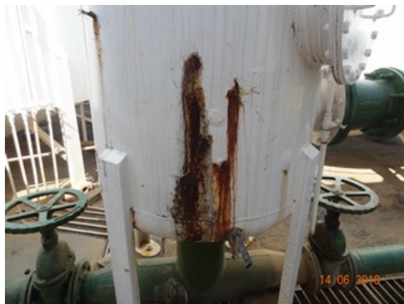
Foto 5 - ETA/Pedro Ludovico Filtração - vazamento e corrosão no filtro.
