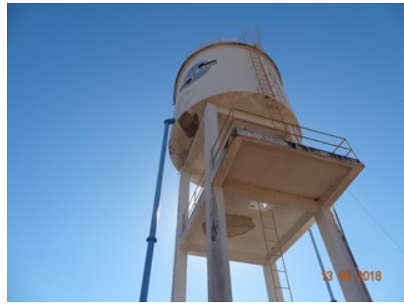
Foto 8 - REL da ETA com perda de revestimento e ausência de sem guarda-corpos na escada de acesso até à plataforma.
