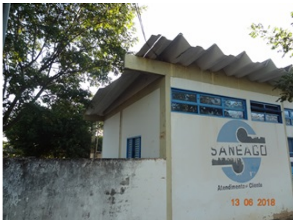
Foto 1 - Pintura desgastada das edificações do distrito.
