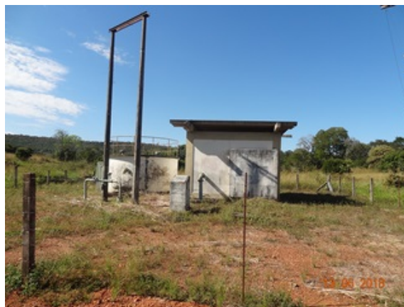
Foto 6 - Poço de sucção e EEAB com pintura desgastada.
