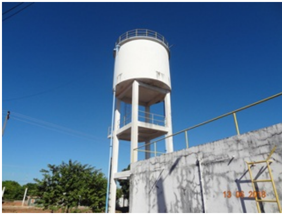
Foto 7 - RAP e REL da ETA com pintura desgastada.
