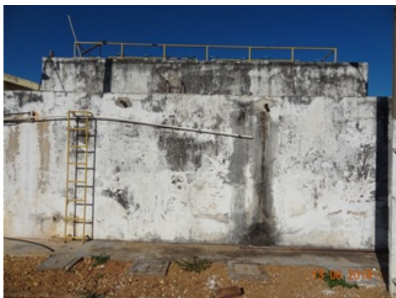
Foto 5 - Falta guarda-corpos no topo do poço de contato.
