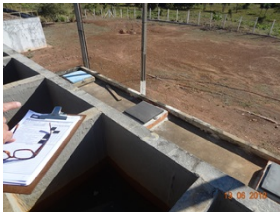
Foto 4 - Falta guarda-corpos no topo do poço de contato.
