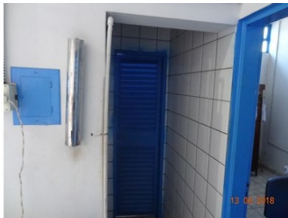
Foto 2 - Ausência de sinalização indicativa para banheiro e bebedouro.
