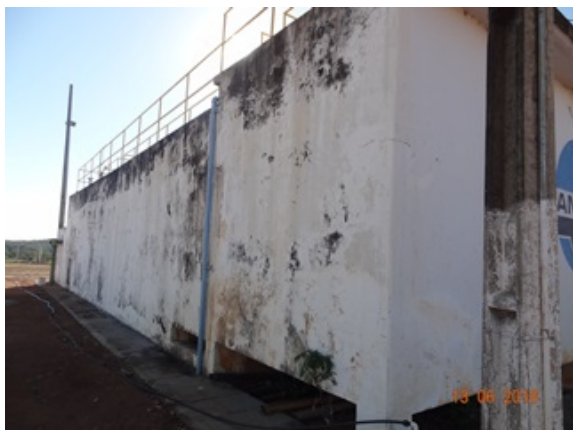
Foto 3 - Pintura desgastada das edificações da ETA.
