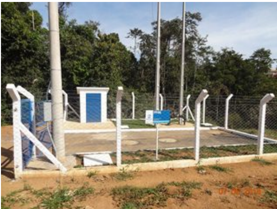
Foto 7 - Poço de captação de água bruta - Alto Paraíso
