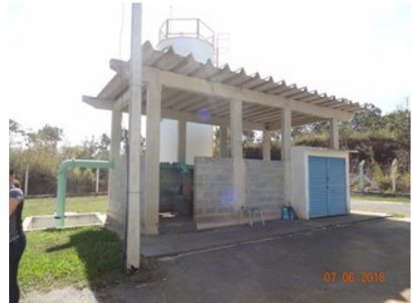
Foto 8 - Elevatória - Independência Mansões II
