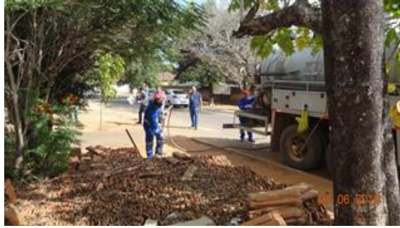
Foto 4 - Limpeza da rede de esgoto sendo executada na avenida A no momento da fiscalização.
