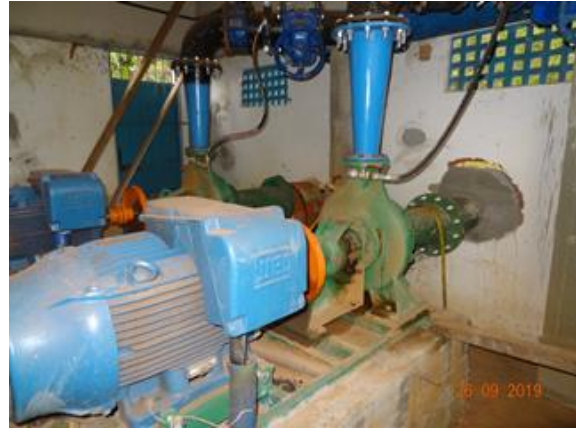
Foto 2 - conjunto moto-bomba da captação sem vazamento
