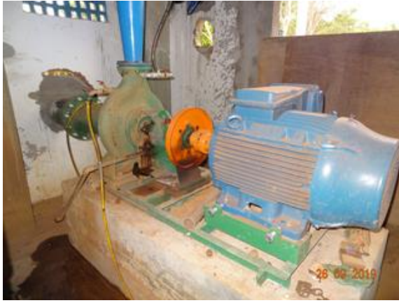
Foto 1 - conjunto moto-bomba da captação sem vazamento
