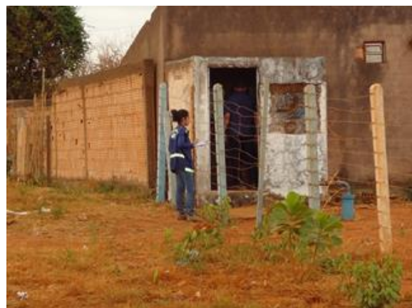
Foto 4 - Poço Tetra P 03 - Sistema de Tratamento de Água Mingone II - com edificações sem pintura e infraestrutura danificada.
