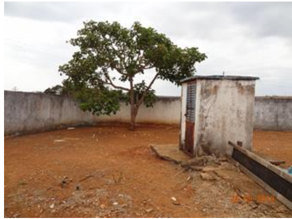
Foto 6 - Poço Osfaya 01 com edificações com pintura desgastada e infraestrutura danificada (ferrugem e rachaduras)
