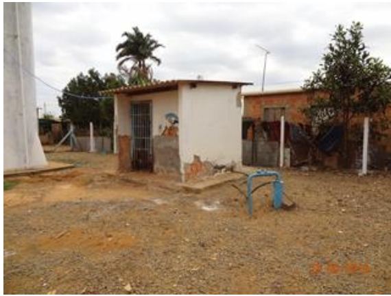
Foto 5 - Poço Caixa Prefeitura/Sistema de Tratamento de Água Mingone II com perda de revestimento e infraestrutura danificada
