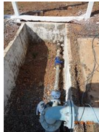
Foto 2 - Reservatório Casa de Telhas com dispositivo de macromedição.
