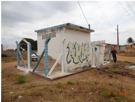
Foto 7 - Poço Faro com edificações com pintura danificada e infraestrutura danificada com perda de revestimento.
