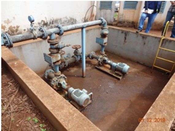
Foto 3 - EEAT com bomba reserva instalada.
