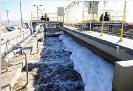
Abastecimento de Água e Esgotamento Sanitário
