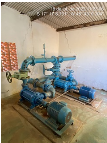
Foto 1 - Vazamento da bomba consertado.
