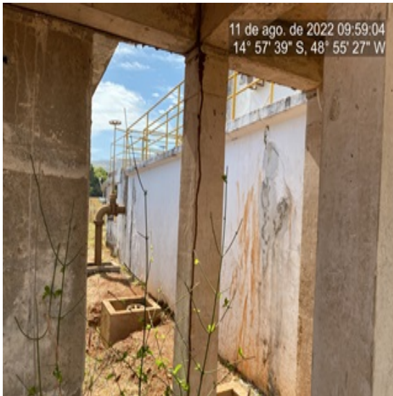
Foto 1 - Novas infiltrações detectadas na ETA .
