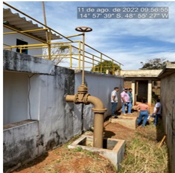
Foto 2 - Novas infiltrações detectadas na ETA.
