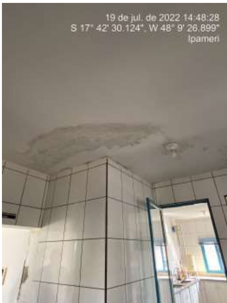
Foto 5 - ETA com presença de infiltração.
