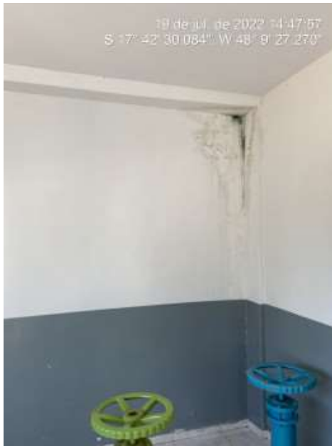
Foto 7 - ETA com presença de infiltração.
