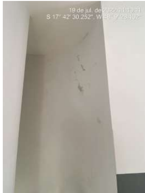
Foto 4 - Parede na ETA com resquícios de infiltração.
