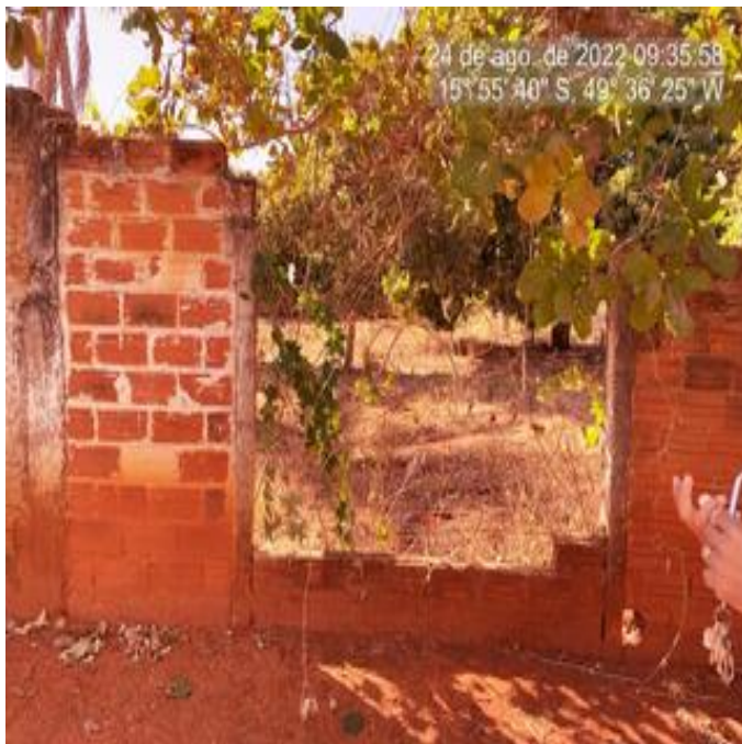
Foto 5 - Centro de Reservação com muro e cerca de proteção.
