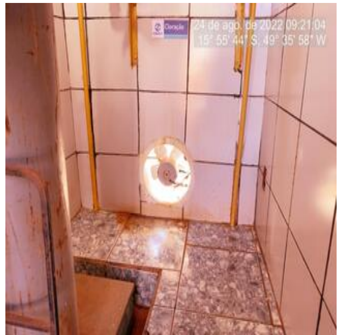
Foto 2 - Sala do clorador com exaustor funcionando.
