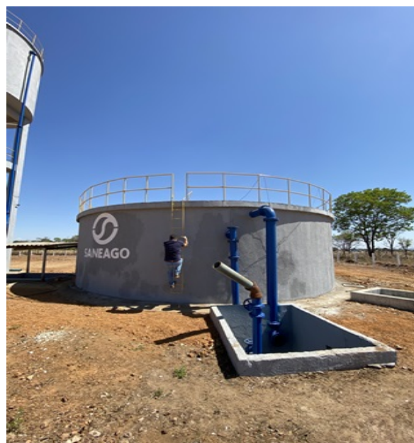
Foto 8 - RAP com caixa de passagem e registro de saída sem grade de proteção e escada sem guarda-corpo.
