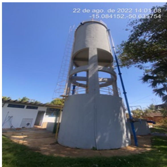
Foto 5 - REL da ETA sem guarda corpo no lance inicial da escada.
