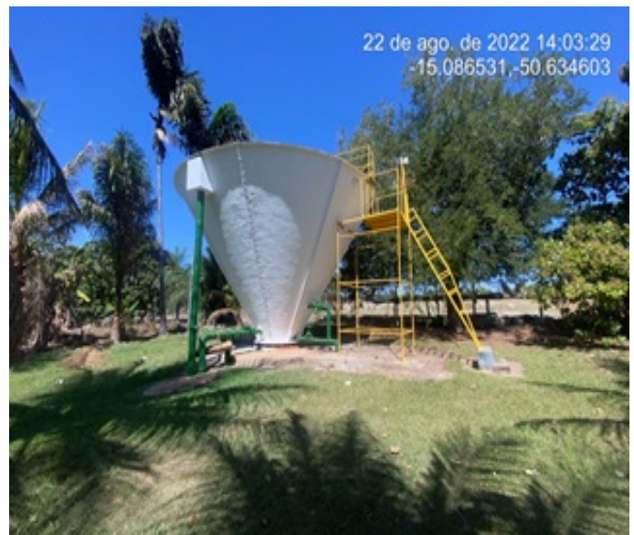
Foto 4 - ETA com filtro russo sem guarda corpo na escada de acesso ao topo.
