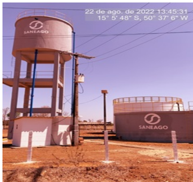
Foto 6 - REL do CR sem guarda corpo no lance inicial da escada.
