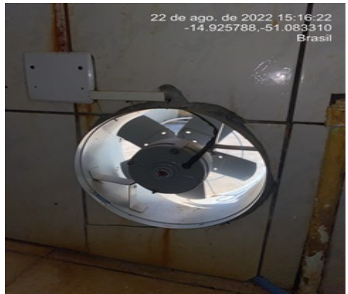
Foto 2 - ETA, sala de cloração com exaustor instalado.
