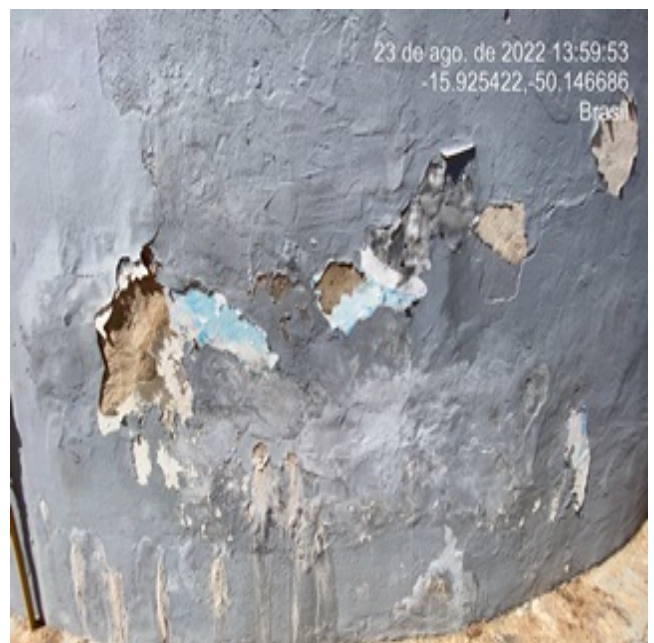
Foto 6 - RAP da ETA Pedro Ludovico (500 m 3 ) com infiltrações, perda de revestimento e pintura desgastada (em detalhe).
