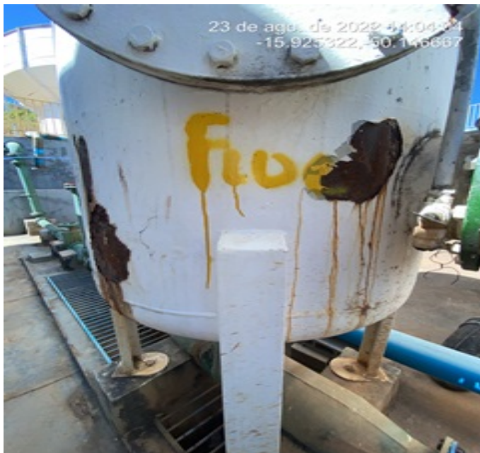
Foto 3 - ETA Pedro Ludovico com filtro misturador com corrosão.
