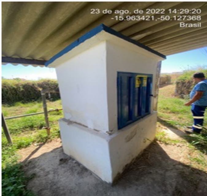
Foto 9 - Poço 04 - Papyrus abrigo do quadro de comando recuperado (em outro ângulo).
