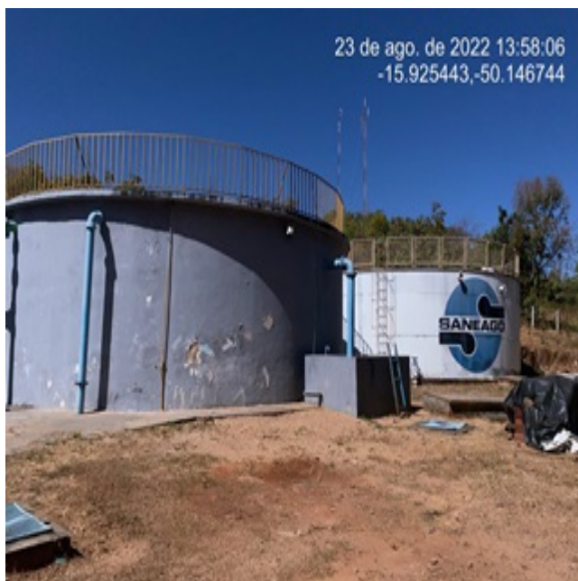
Foto 5 - RAP da ETA Pedro Ludovico (500 m 3 ) com infiltrações, perda de revestimento e pintura desgastada.
