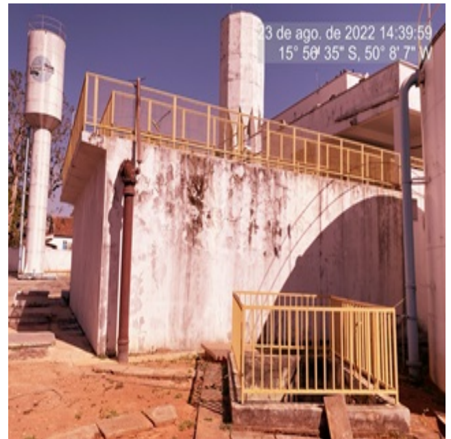
Foto 10 - ETA Bacalhau com pintura desgastada nas edificações.
