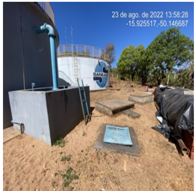
Foto 4 - ETA Pedro Ludovico com caixas de passagem com tampas.
