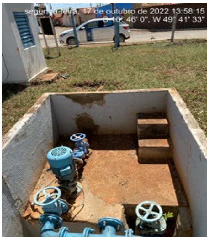
Foto 5 - EEAT/Bela Vista, recomenda-se instalação de grade proteção.
