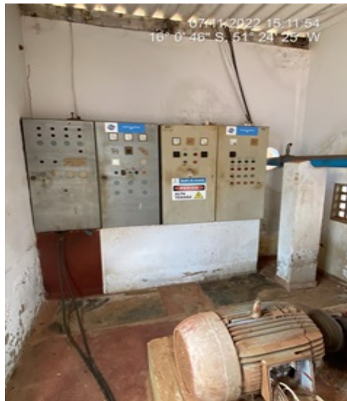
Foto 2 - EEAT/ETA II com quadro de comando com aviso de risco.
