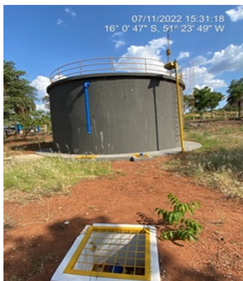
Foto 8 - RAP RI com caixa de passagem do macromedidor com grade de proteção.
