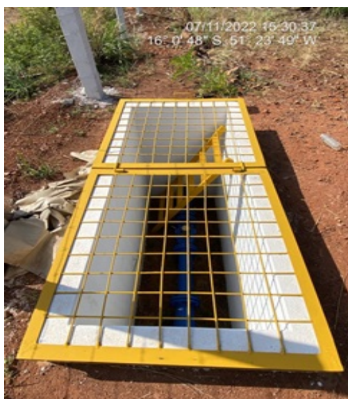
Foto 7 - Caixas de manobra com tampa de proteção instaladas.
