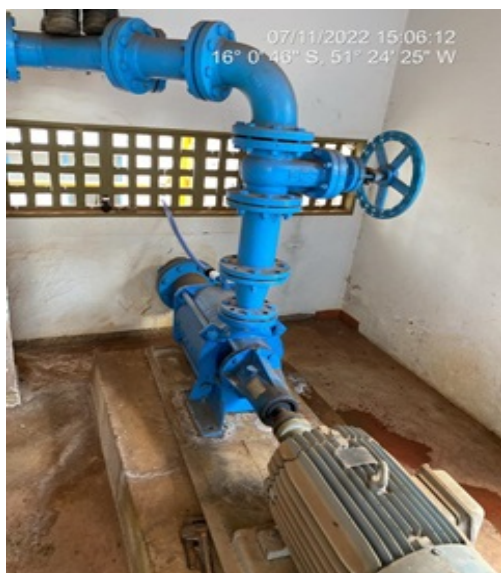
Foto 5 - ETA I com vazamentos corrigidos.
