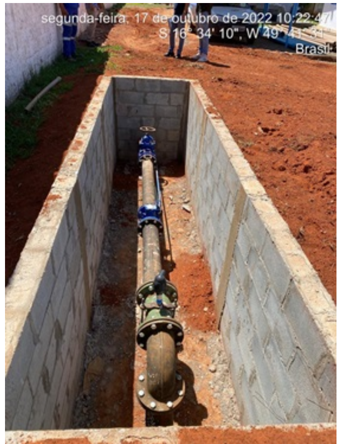
Foto 8 - REL Distrito com caixa do macromedidor sem tampa ou grade de proteção.
