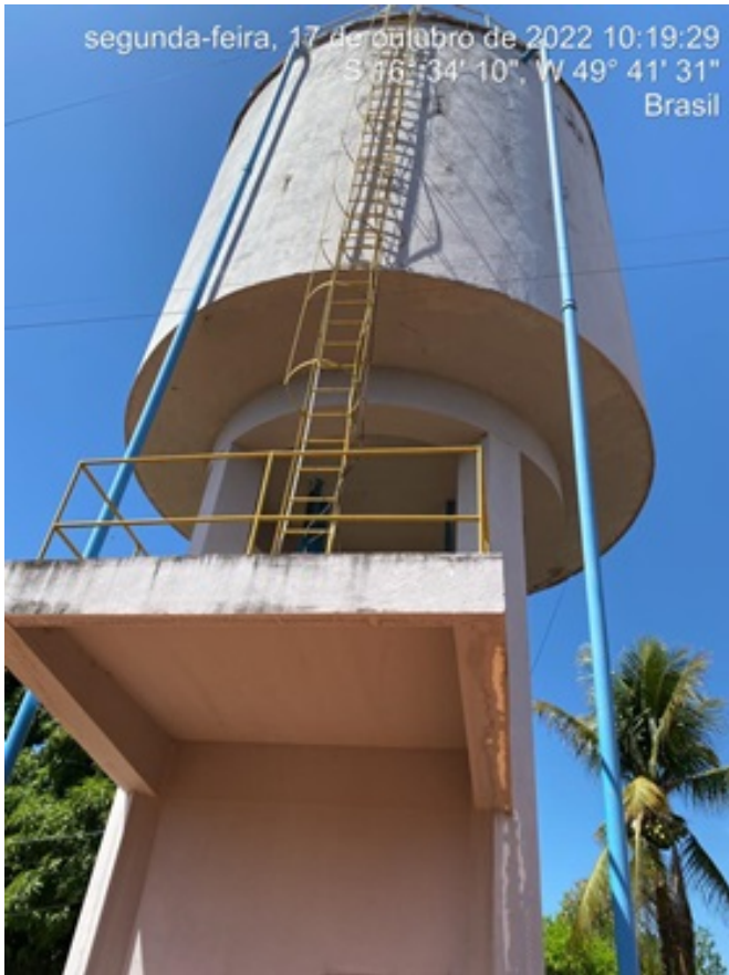
Foto 5 - REL Distrito com guarda corpo instalado na escada de acesso ao topo.
