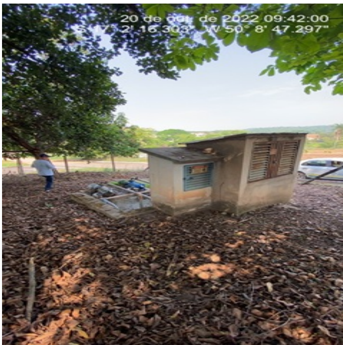
Foto 7 - EEAT do setor central com abrigo do quadro de comando com pintura desgastada.
