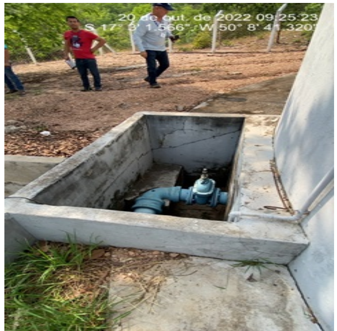
Foto 6 - RAP da zona rural com caixa de passagem sem tampa ou grade de proteção.
