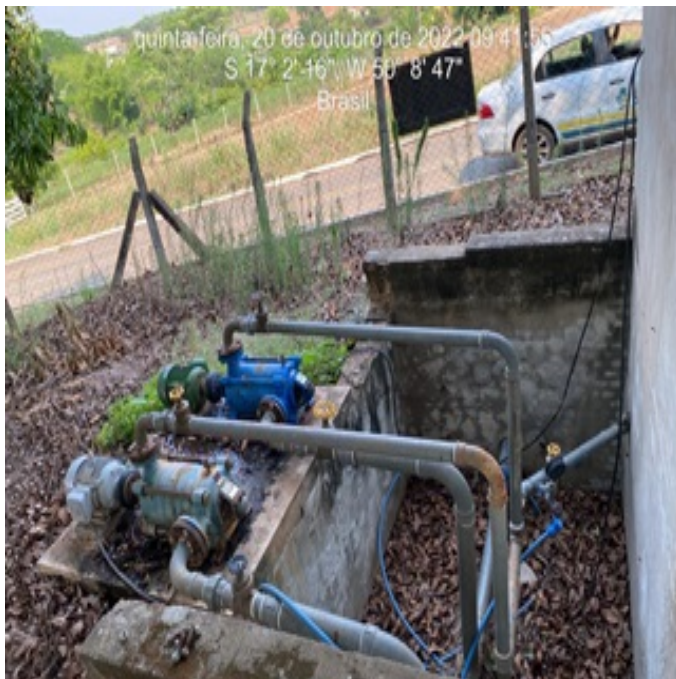
Foto 5 - EEAT setor central com caixa de passagem sem tampa ou grade de proteção.
