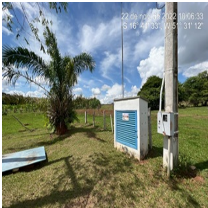
Foto 2 - Poço 02 abrigo do quadro de comando com pintura recuperada.
