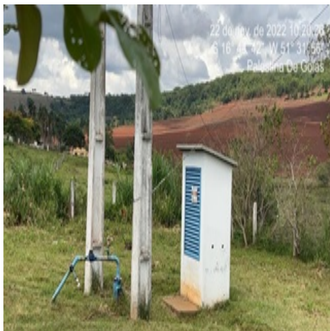
Foto 4 - Poço 01 com abrigo do quadro de comando com pintura recuperada.
