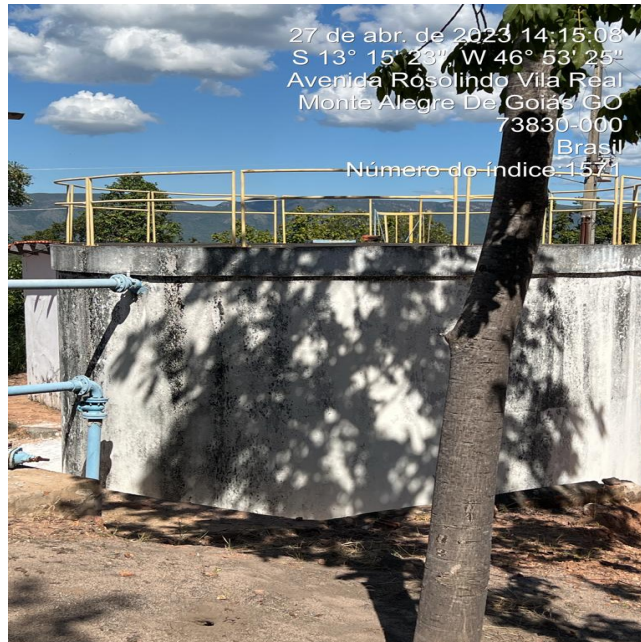
Foto 2 - ETA/RAP de 100 m 3 com pintura desgastada.
