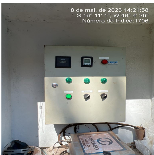
Foto 1 - Quadro de comando do Poço P329 sem aviso de risco de choque elétrico.
