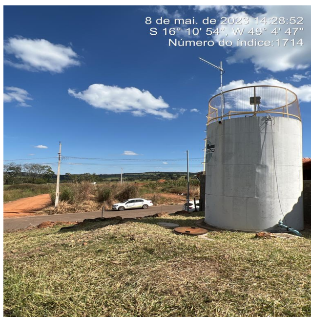
Foto 2 - Centro de Reservação/Souzaânia com cerca de proteção da área urbanizada danificada.
