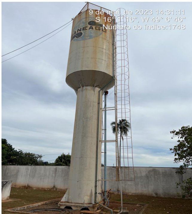
Foto 1 - REL/cidade com corrosão e pintura danificada.
