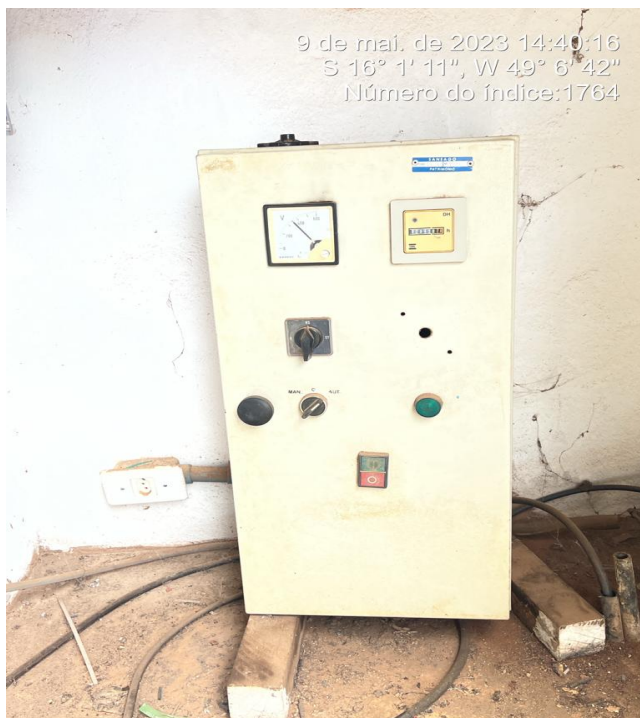
Foto 3 - Poço P1 sem aviso de risco no quadro de comando.
